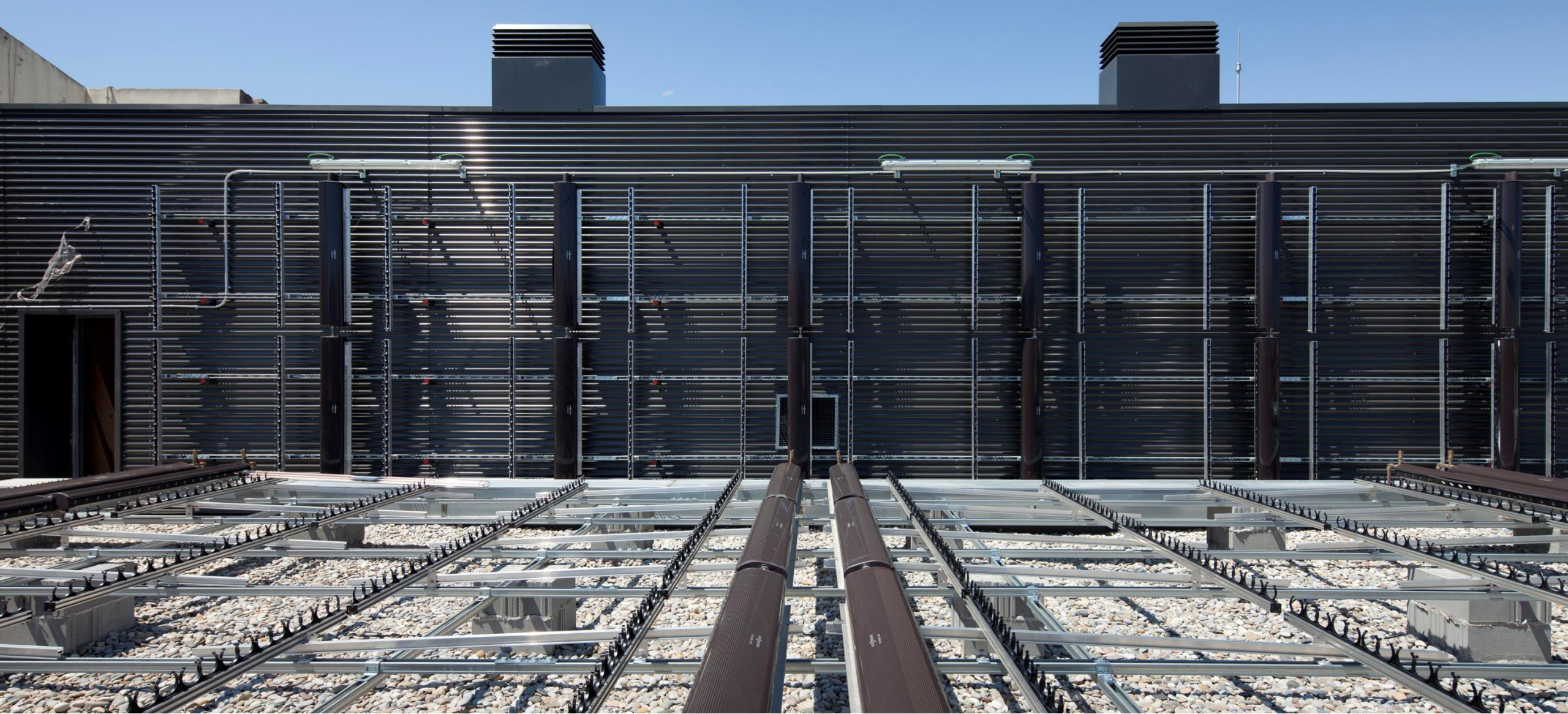
Bombas de Calor Geotérmicas – Impacto Nicolás Pintor C. 06 de Noviembre de 2019
