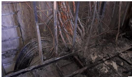
Cableado corrientes débiles
