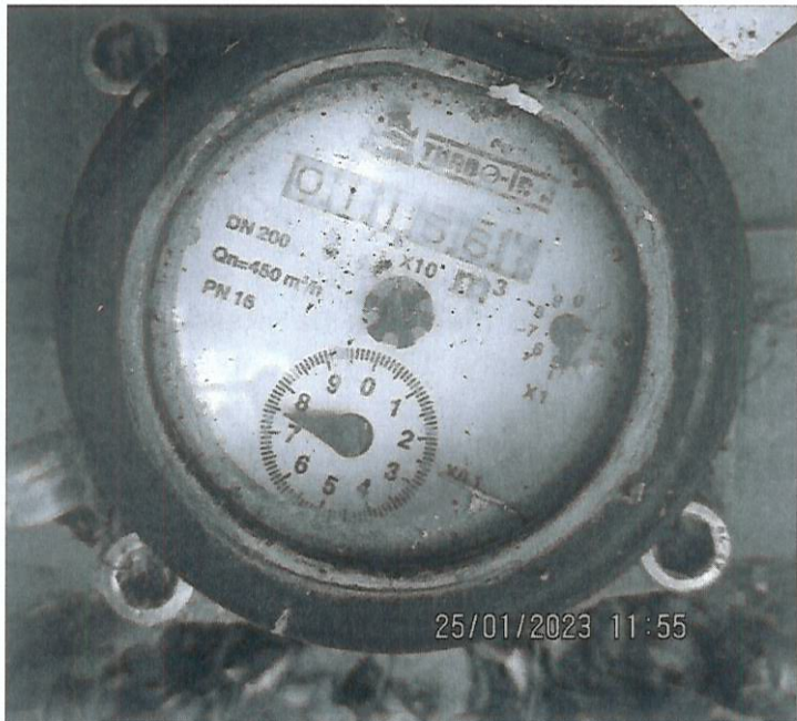
Fotografía N°6: Vista del totalizador del caudalímetro instalado en la tubería asociada al sistema de captación de aguas no autorizado, en la ribera izquierda del Estero Derecho.
