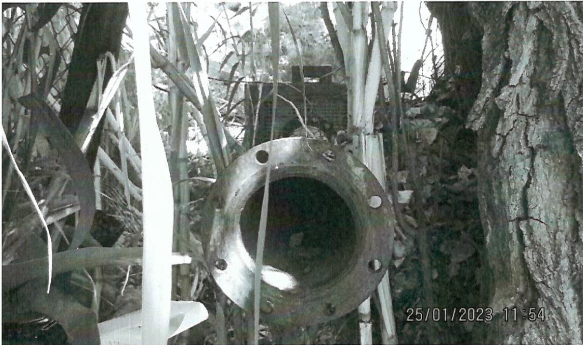
Fotografía N°4: Vista de tubería asociada al sistema de captación de aguas no autorizado, ubicado en la ribera izquierda del Estero Derecho, ubicado posteriormente
