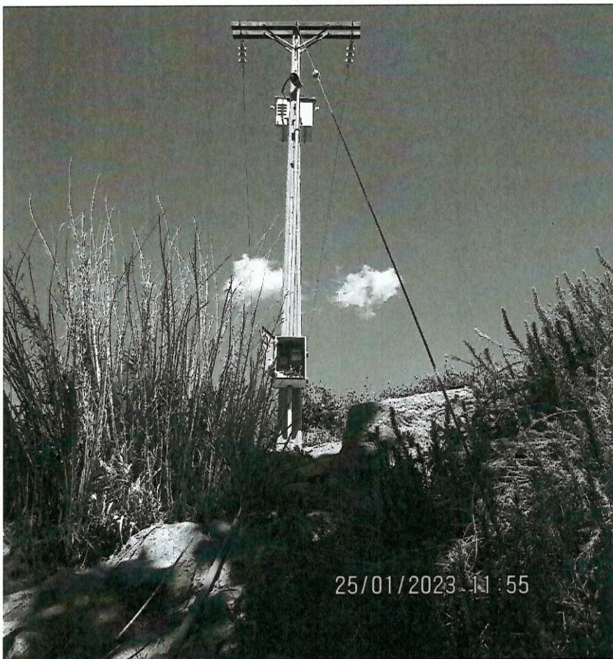
Fotografía N°7: Vista a poste de hormigón e instalación eléctrica, ubicadas en altura a nivel de los cultivos (vides), en la ribera izquierda del Estero Derecho.
