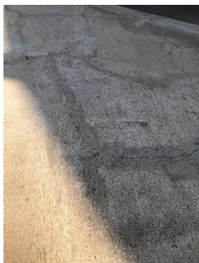
Foto N°17: Fisuras en pavimentos interiores del estadio
