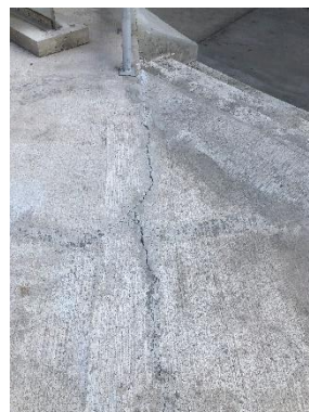
Foto N°18: Fisuras en pavimentos interiores del estadio
