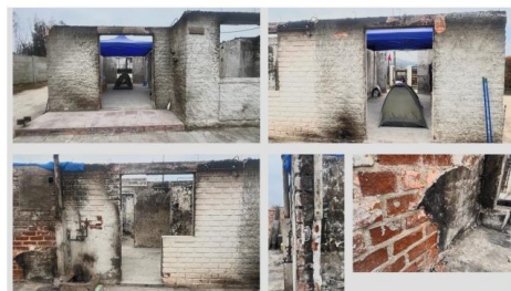
Ilustración 7: Imágenes fachadas viviendas siniestradas - Fuente: Elaboración propia
