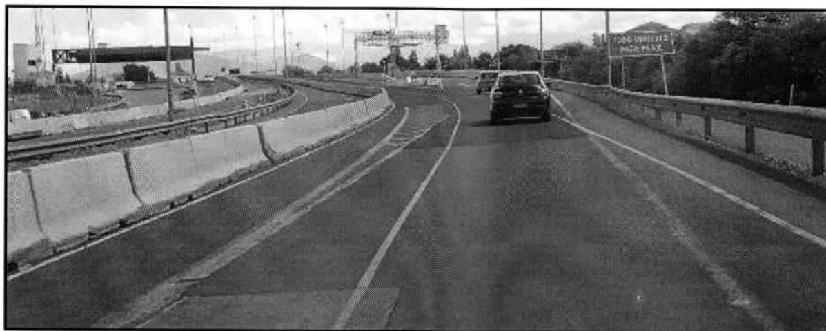
Foto 1: Tramo 1.4, calzada derecha. Demarcación deficiente en tramo, falta fresado, borrado de líneas prexistentes y redemarcar líneas de borde y eje.
