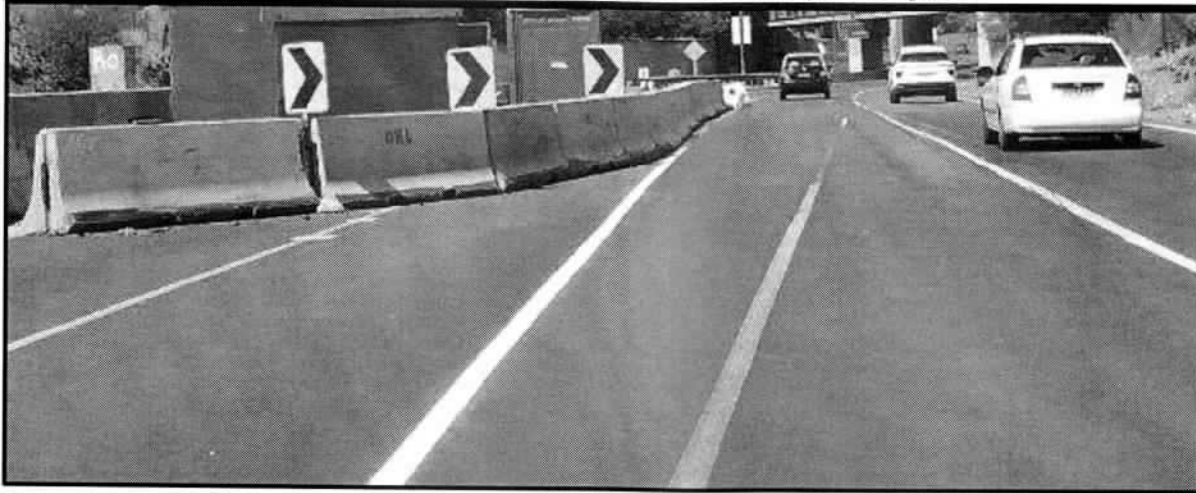
Foto 14: Tramo 1.1, calzada izquierda. Demarcación deficiente en sector cambio de alineamiento, falta fresado, borrado de líneas preexistentes y redemarcar líneas de borde y eje.
