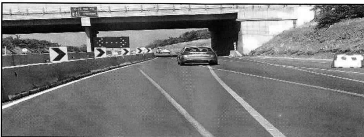
Foto 13: Tramo 1.2, calzada izquierda. Demarcación deficiente en sector cambio de alineamiento, falta fresado, borrado de líneas preexistentes y redemarcar líneas de borde y eje.
