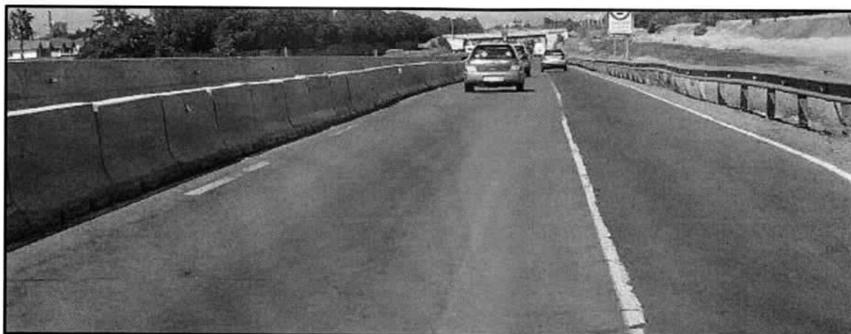
Foto 10: Tramo 1.3, calzada izquierda. No se cumple con pistas de 3,0 metros. No se demarcó este tramo cuando se habilitó este nuevo desvío. Se dejó pista rápida de 3,5 m y pista lenta de 2,5 m. No se levantó la observación de 2da Etapa establecido en Protocolo de Aprobación.
