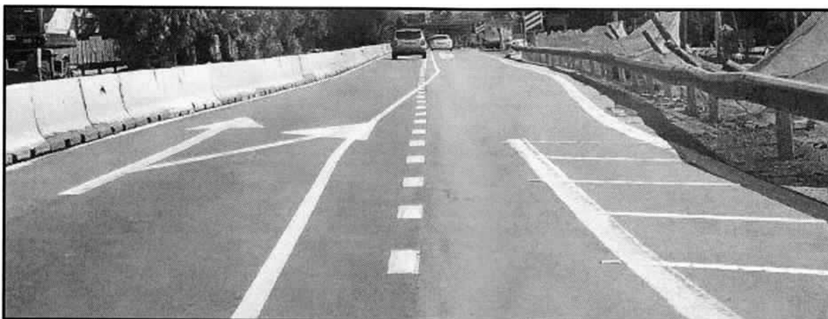
Foto 4: Tramo 2.4, calzada derecha. Demarcación deficiente en tramo, falta fresado, borrado de líneas preexistentes y redemarcar líneas de borde y eje.
