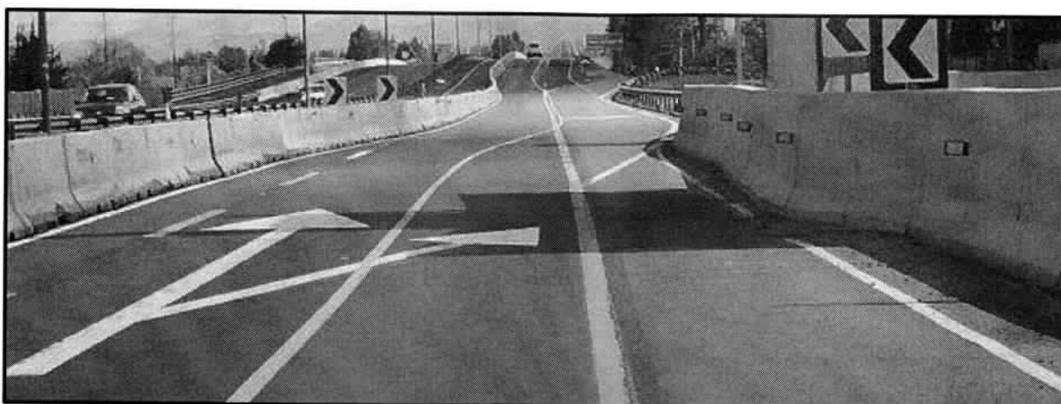
Foto 6: Tramo 2.4, calzada derecha. Demarcación deficiente en tramo, falta fresado, borrado de líneas preexistentes y redemarcar líneas de borde y eje.
