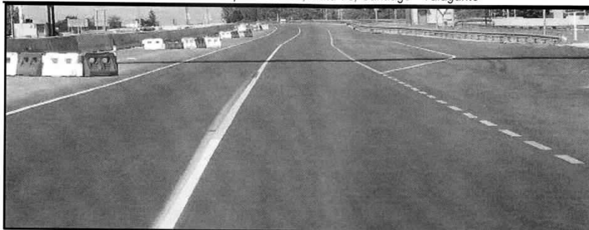
Foto 8: Tramo 2.2, calzada izquierda. Demarcación presenta sobre ancho en eje central.
