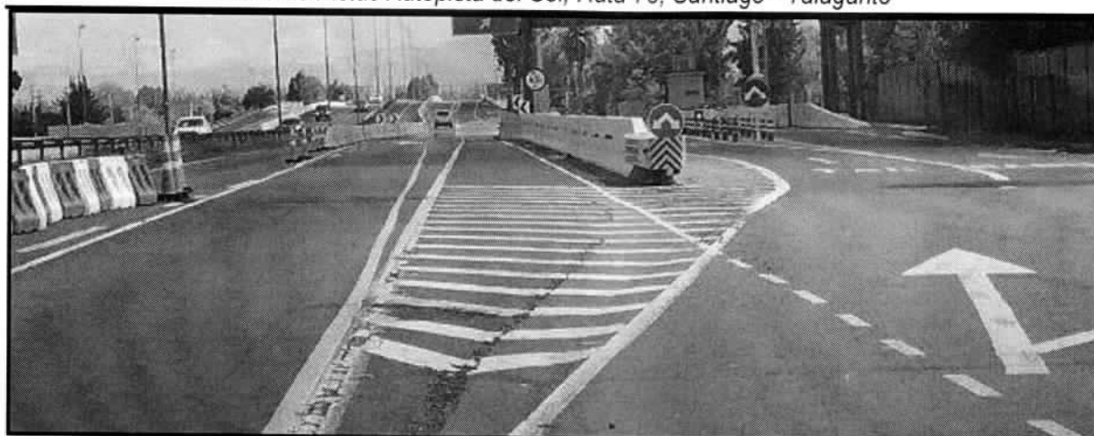
Foto 5: Tramo 2.4, calzada derecha. Demarcación deficiente en tramo, falta fresado, borrado de líneas preexistentes y redemarcar líneas de borde y eje.
