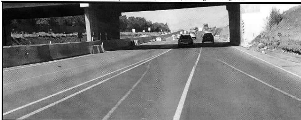
Foto 11: Tramo 1.3, calzada izquierda. Demarcación deficiente en tramo, falta fresado, borrado de líneas preexistentes y redemarcar líneas de borde y eje.
