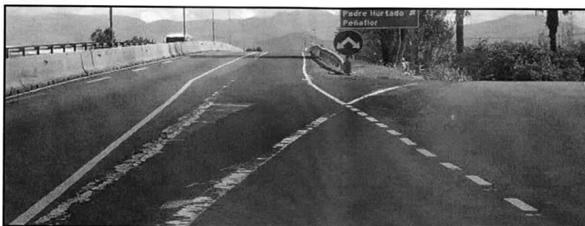
Foto 7: Tramo 2.4, calzada derecha. Demarcación deficiente en tramo, falta fresado, borrado de líneas preexistentes y redemarcar líneas de borde y eje.
