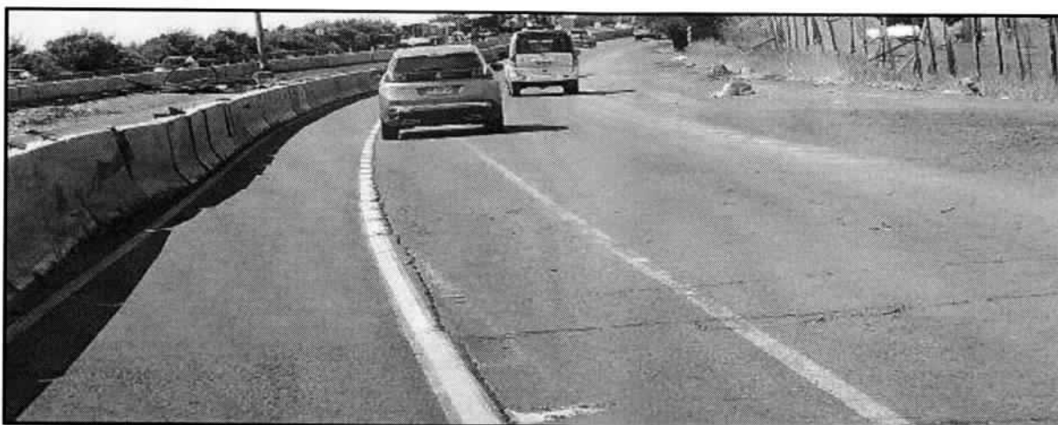
Foto 9: Tramo 1.4, calzada izquierda. Demarcación deficiente en tramo, falta fresado, borrado de líneas preexistentes y redemarcar líneas de borde y eje.
