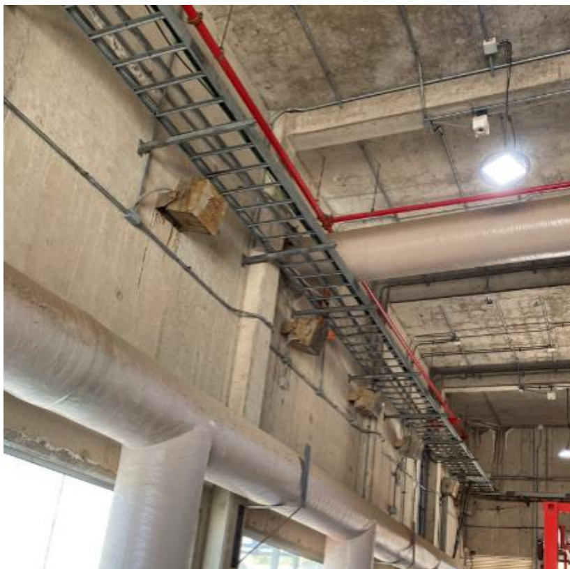
Ilustración 2: Equipo de extinción de incendio dañado.
