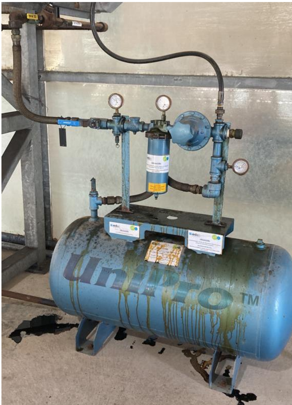
Ilustración 5: Acumulador de nitrógeno corroído.
