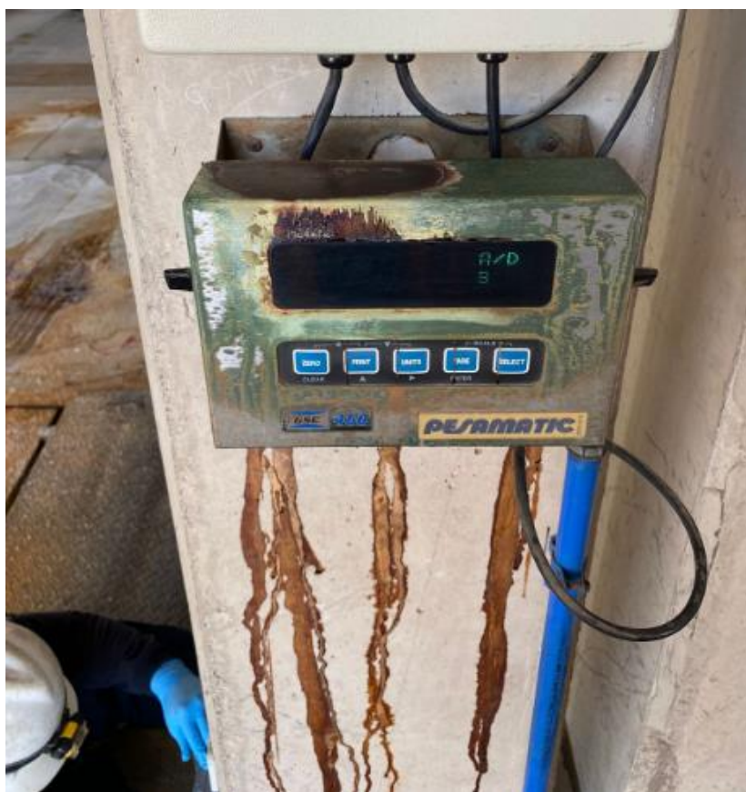
Ilustración 1: Transmisor de la báscula dañado por gas cloro.
