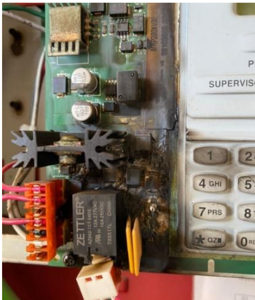
Ilustración 4: Electrónica dañada en general por reacción del cloro gas.
